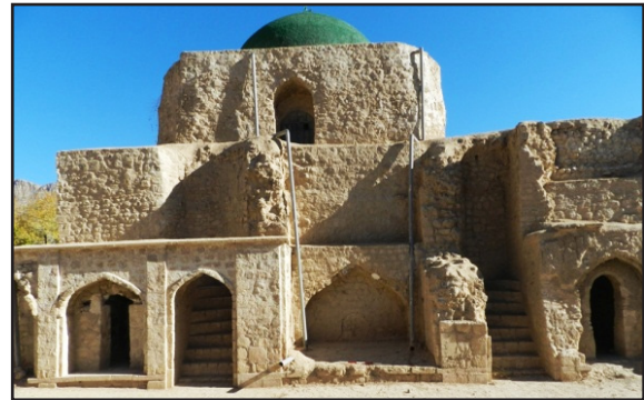
تصویر ۸. ایوان مسدودشده در ضلع غربی بنا و پلکان‌های منتهی به طبقات بالای خرقة (عکس از: نگارندگان، ۱۳۹۵).
